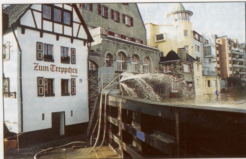
Mobile Hochwasserschutzwand in der Mitte einer Straße montiert
